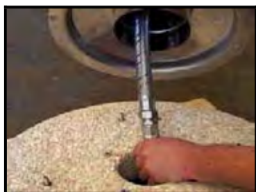
17 - Συνδέστε τον εύκαμπτο σωλήνα που βγαίνει έξω από τη ντουζιέρα με εκείνον στο έδαφος
